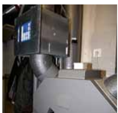
Die Lüftungsanlage versorgt das Haus mit Frischluft.
