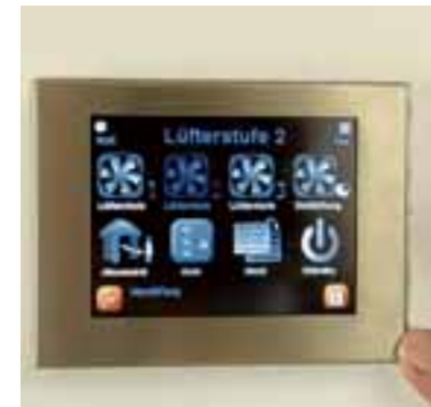
Fenster öffnen ist nicht mehr, das übernimmt die Lüftungsanlage.
